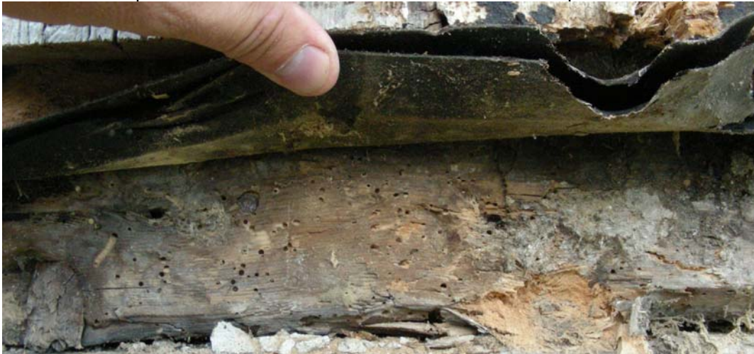
De petits trous dans la charpente tendre, mais rien ailleurs.
